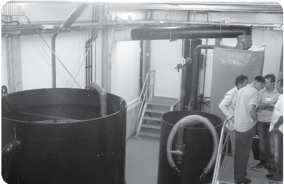
Filters van de recirculatiesystemen van IMARES in Yerseke
